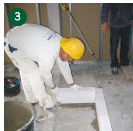
Läget för väggarna i ett rum markeras. Första skiftet monteras i KC-bruk. Höjd 200 alt. 400 mm i första skiftet.
